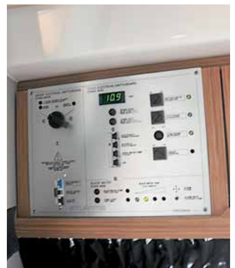
Zentral und gut zugänglich angeordnet wirkt die Bordelektrik.
