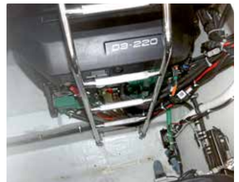
Stabile Leiter für den Zugang zum Maschinenraum.
