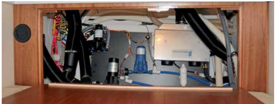
Inspektionsluke in der Unterflurkabine.
