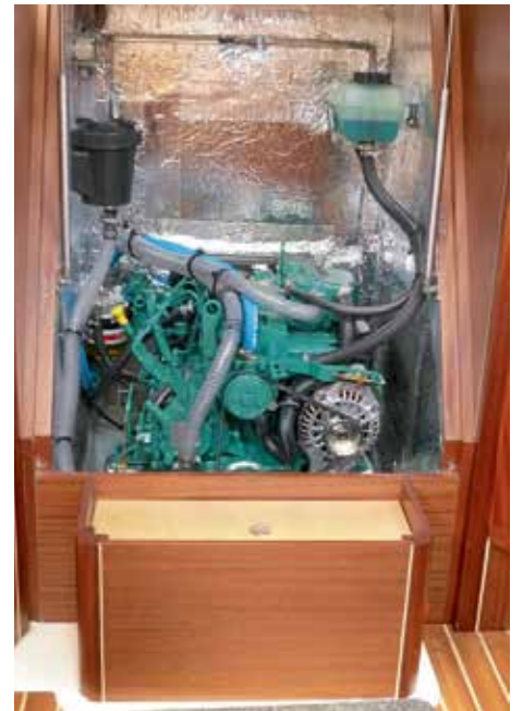
Nimmt man den Niedergang weg, kommt man gut an den Motor.
