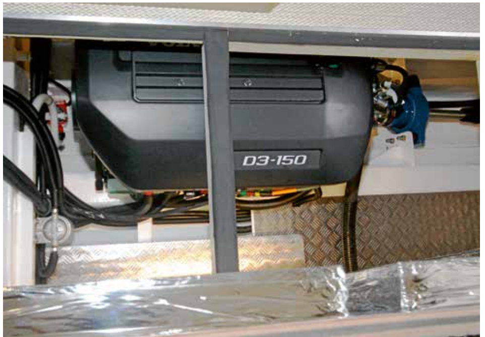
Bestens gedämmt, der Volvo Penta Diesel D3-150 unter dem Salonboden.
