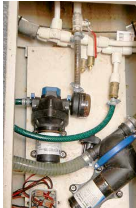
Bequem zu erreichen, Pumpen und Absperrhähne unter dem Kabinenboden.
