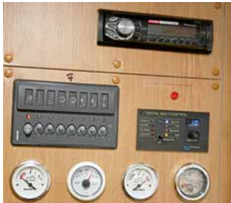
Zentrale Schalt- und Füllstands-Armaturen über dem Niedergang in die Eignerkabine.
