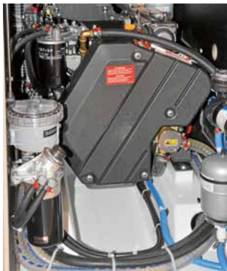
Der Motor ist für Wartungsarbeiten gut zugänglich und sauber installiert.
