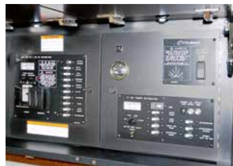
So übersichtlich ist das Elektropaneel.
