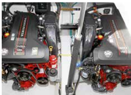
Sauber installiert, die beiden Volvo-Penta-320-V8-Benzin-Boliden.
