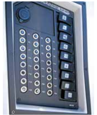
Übersichtlich und gut zu erreichen im Fußraum, Kippschalter und Sicherungen.
