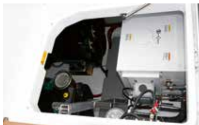
In den Maschinenraum führt eine einfache Leiter. Ein Austausch der Motoren ist nicht vorgesehen.
