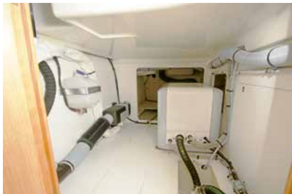
Hinter der Nasszelle an Steuerbord läuft der Generator.
