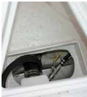
Kraftstoffabsperrrhahn im Ankerkasten.
