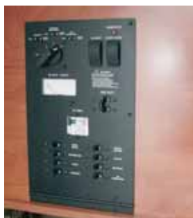
Das Paneel für den Landstromanschluss.
