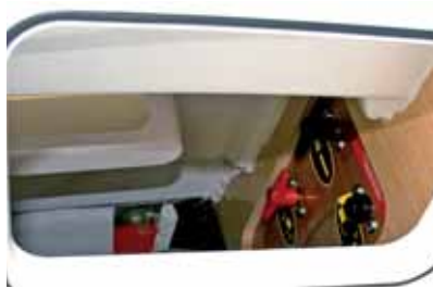
Batterie Hauptschalter sind leicht zugänglich.
