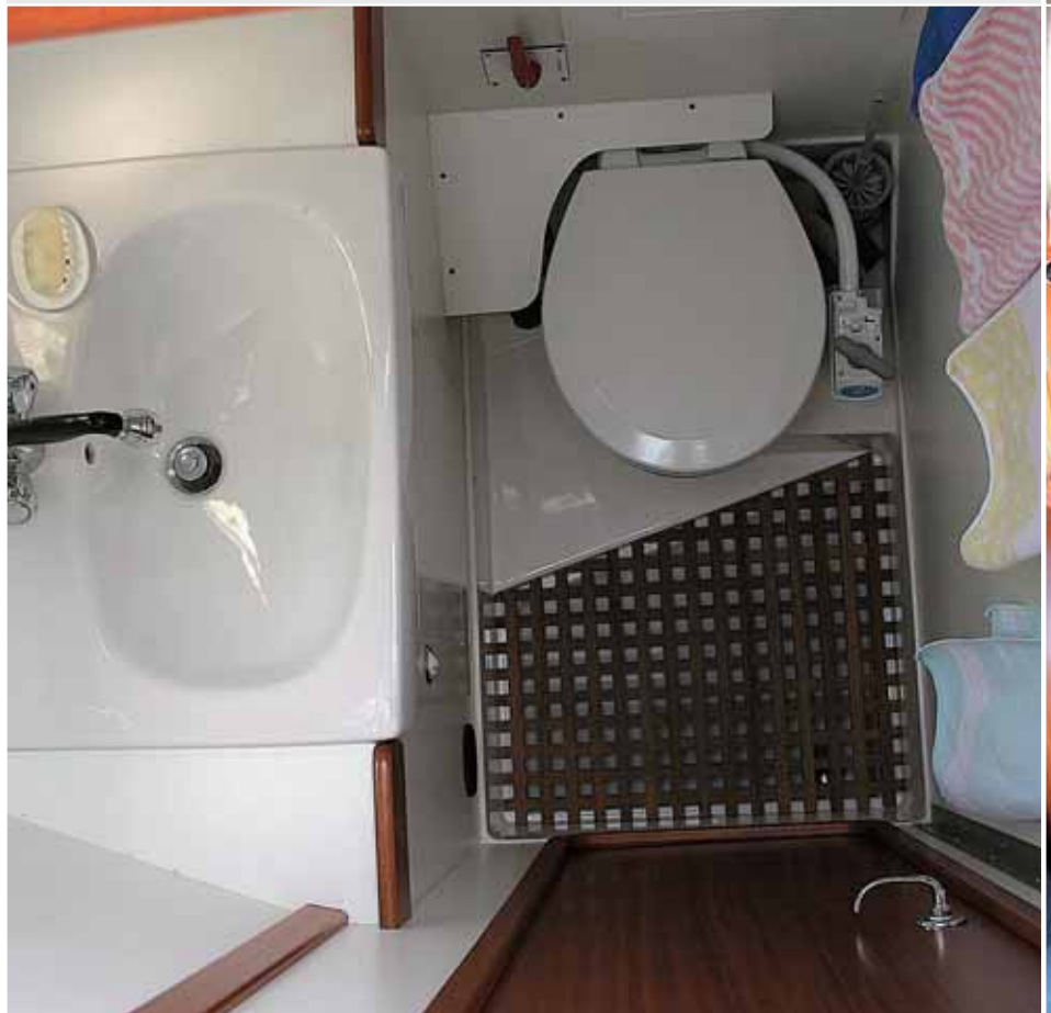
Unten: Die Nasszelle ist Toilette, Bad und Dusche in einem. Der serienmäßig eingebaute Boiler liefert warmes Wasser. Erwärmt wird dieses durch das Kühlwasser des Motors oder durch eine Heizspirale mit Landstrom.
