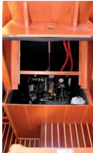
Der Motor ist unter den Niedergangsstufen eingebaut.
