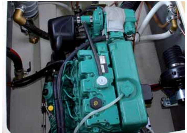
Bestens vom Cockpit aus zugänglicher Motorraum.
