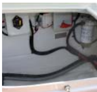
Zugang zu Filter, Hauptschalter, Batterie etc. unter Lukendeckeln.
