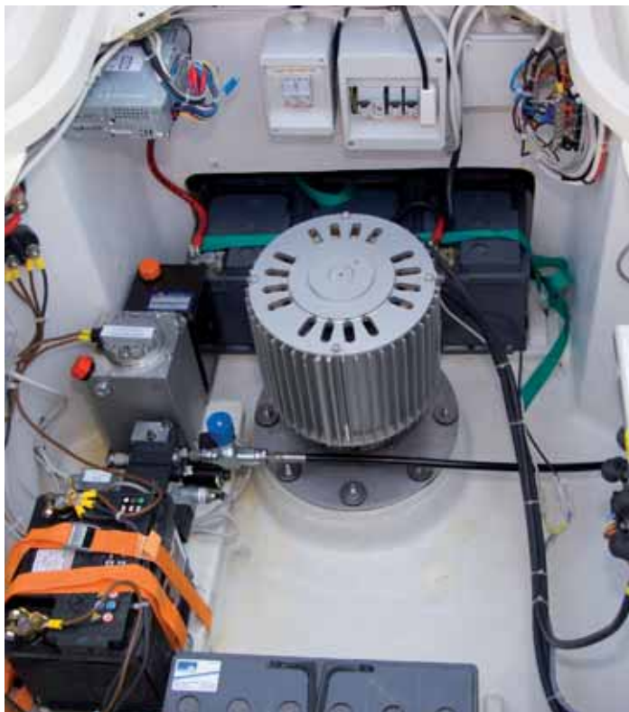
Geballte Technik unter dem Cockpitboden. Elektromotor, Hydraulikpumpe, Batterien und die jeweilige Lade- und Steuertechnik. Gegen Aufpreis kann auch ein Dieselmotor von Yanmar hier eingebaut werden.
