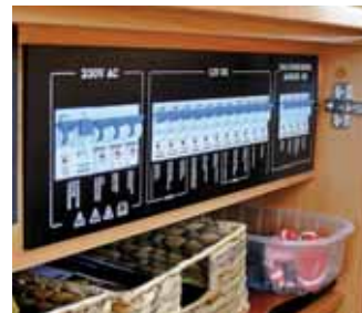
Übersichtlich: die Absicherung.
