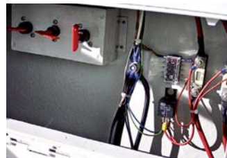
Einfache, übersichtliche Elektrik unter dem Steuerstand.
